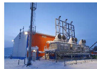
▲チクシに設置した風車 及び発電機建屋
